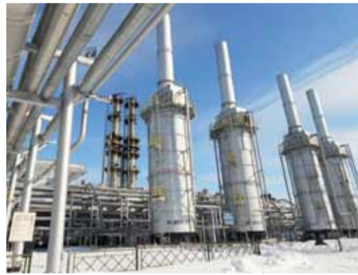
Трубчатые печи установки дезанизации конденсата
