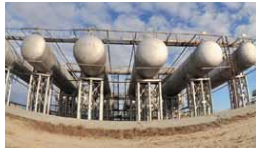
Буллиты головной насосной станции
