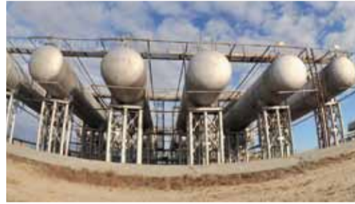
Буллиты головной насосной станции
